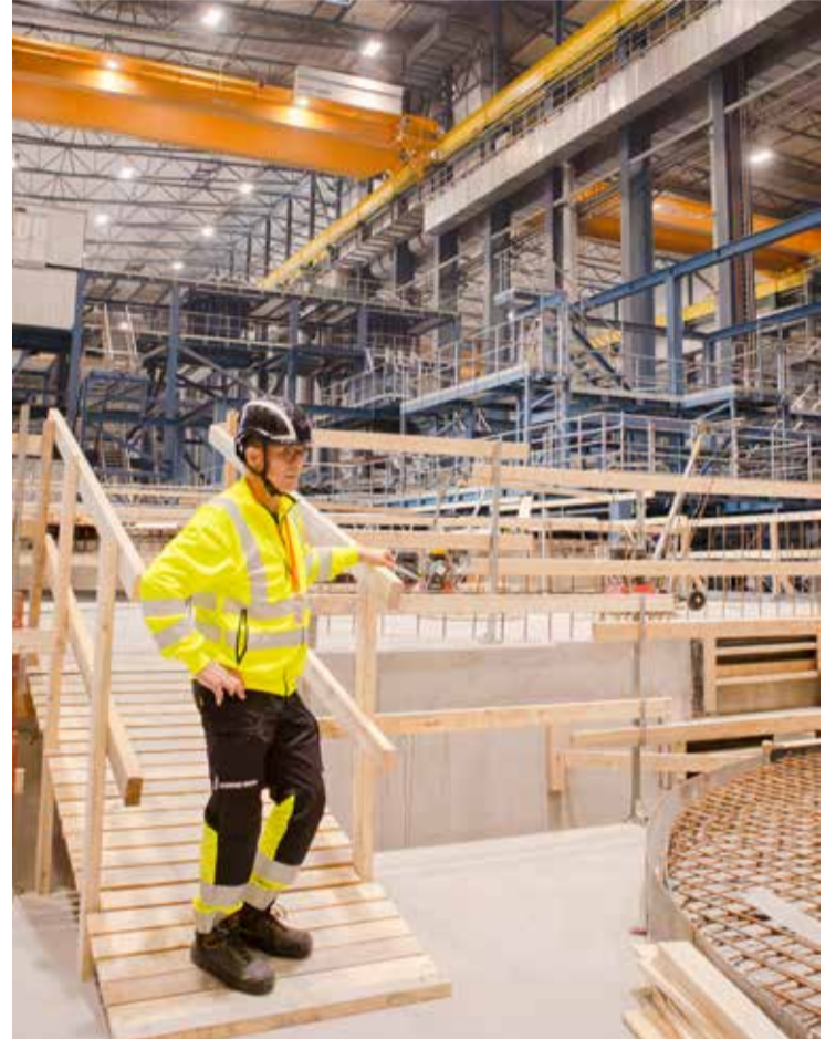
Peder Nensén leder arbetet som ska göra verklighet av ett större Kaunis Iron, med nya dagbrott. Första steget närmar sig nu start, flotationsanläggningen.
